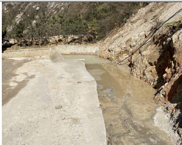
厂区排水沟及沉淀池
